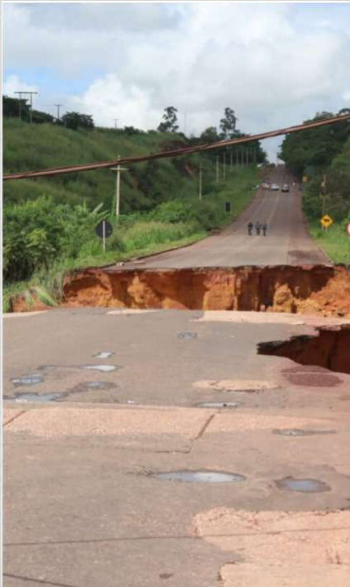
destruição de trecho da BR-222 provocada por enchente em março de 2020 fonte: Associação Comunitária dos Moradores do Piquiá
